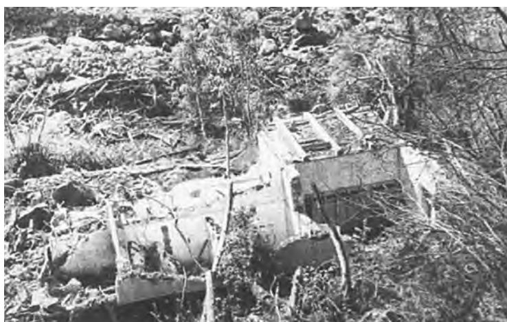
Крыша здания альплагеря «Джантуган» снесена воздушной волной от лавины
